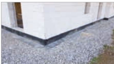
Risolto della guaina impermeabilizzante esterna sulla muratura
