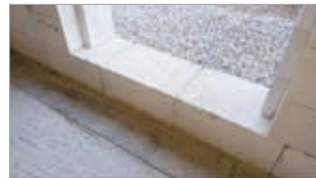
Taglio a L del blocco in opera per spallette, in base alle dimensioni del falso telaio
